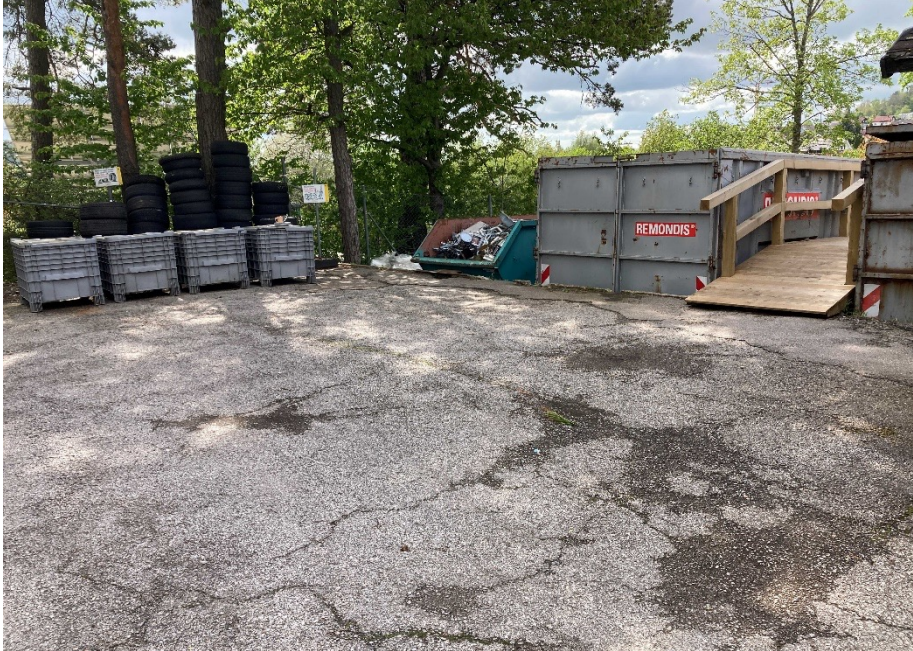
RecyclingCenter Salzstetten ( Containerzugang Anlieferer mit schadhafter Flächenbefestigung)
